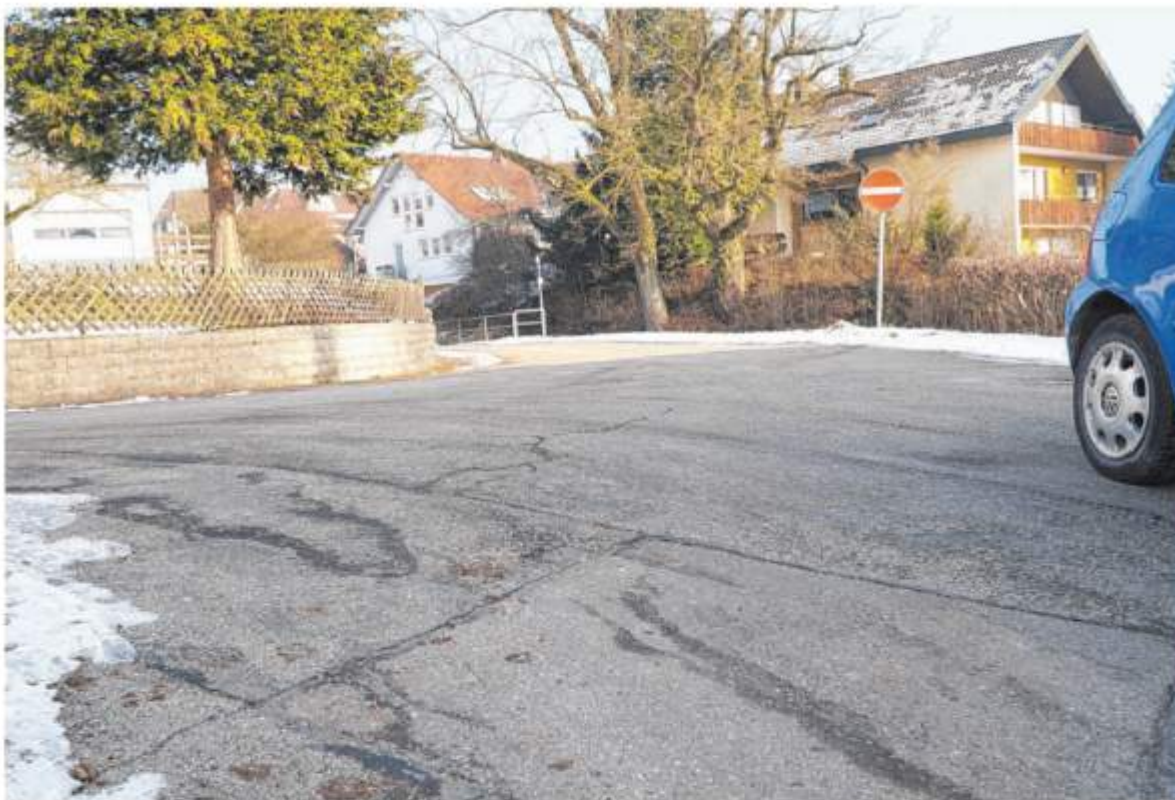
Dieser Teil der Straße im Vogelsang in Rosengarten-Westheim weist die Schadensklasse 1 im Straßenkataster der Gemeinde auf und steht damit auf der Prioritätenliste der Sanierungsmaßnahmen. Foto: Beatrice Schnell
