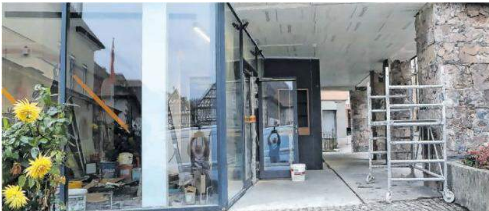
An der neuen Tourist-Information wird noch gewerkelt. Die Stadt verlagert wesentliche Teile vom Marktplatz an den Hafenmarkt. Im April war aufgefallen, dass bei der Planung ein barrierefreier Zugang für die obere Etage fehlt. Das Projekt erhielt dennoch eine Rats-Mehrheit. Foto: ars
