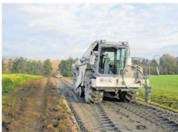
Dieser Feldweg vom Wasserturm in Uttenhofen in Richtung Raibach wurde im November 2011 gebaut. Jetzt werden andere Wege saniert.
