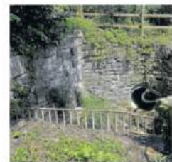
An dieser Stelle verschwindet der Rittersbach kurz vor der Wohnbebauung in der Tullauer Unterwelt. Ein Hochwasserrückhaltebecken könnte für Entlastung sorgen, wäre aber teuer.
