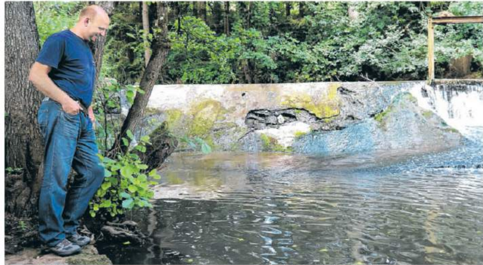
Das marode Wehr in der Bibers an der Bibersstraße in Westheim: Stephen Leutert ist erleichtert, dass die aufwändige Sanierung und die Umgestaltung zur Fischtreppe nun doch nicht alleine auf seinen Schultern lastet. Foto: Beatrice Schnelle
