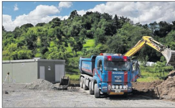
Die Bauarbeiten für ein neues Umspannwerk der Stadtwerke Schwäbisch Hall bei Westheim sind in vollem Gange. Foto: Ufuk Arslan
