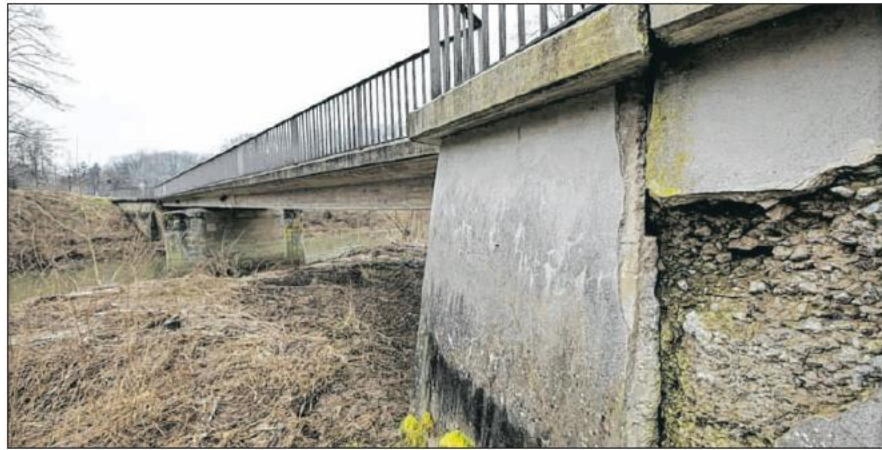
So sieht's aus an der Kocherbrücke der Kreisstraße 2596 zwischen Hirschfelden und Uttenhofen. Die Schäden sind deutlich zu erkennen. Die Brücke ist seit ein paar Tagen für den motorisierten Verkehr gesperrt. Foto: Ufuk Arslan
