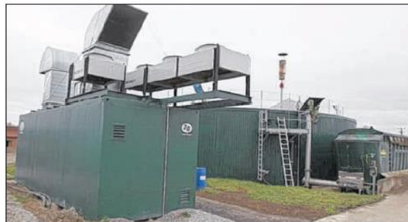
Hier entsteht die Wärme, die dann ins Netz gespeist wird.
