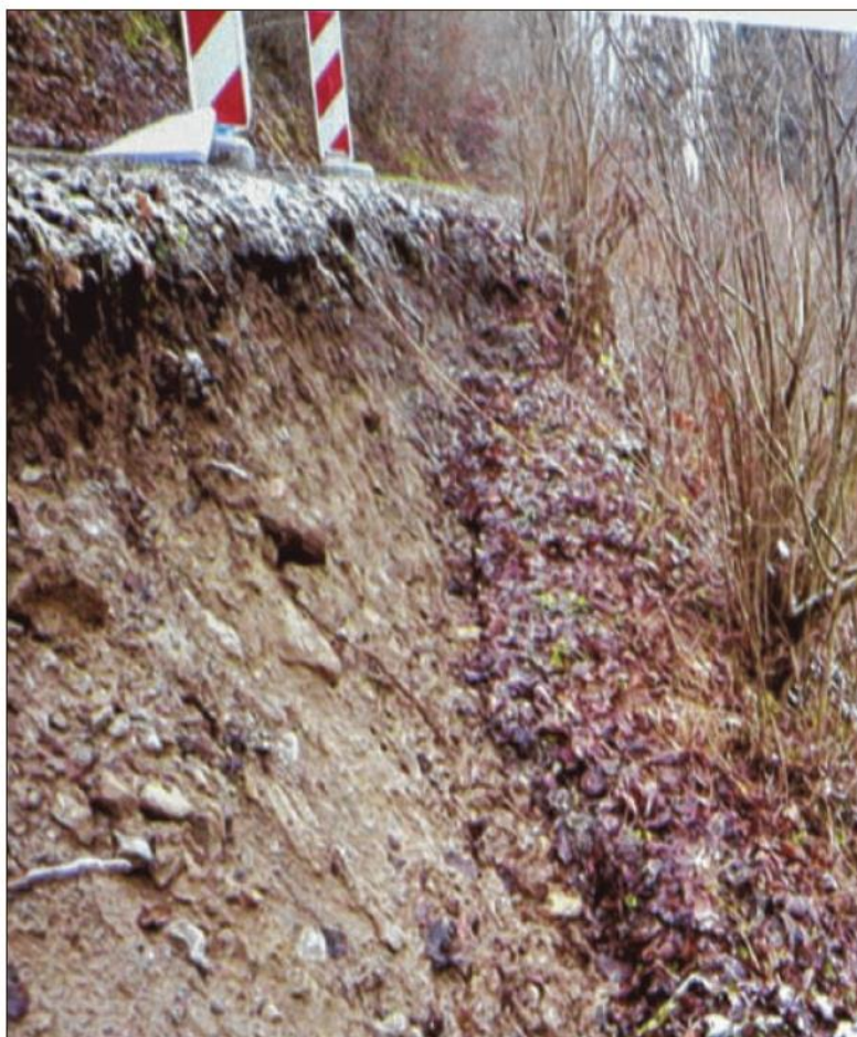
Kaum zu übersehen: Hier rutscht der Hang.
