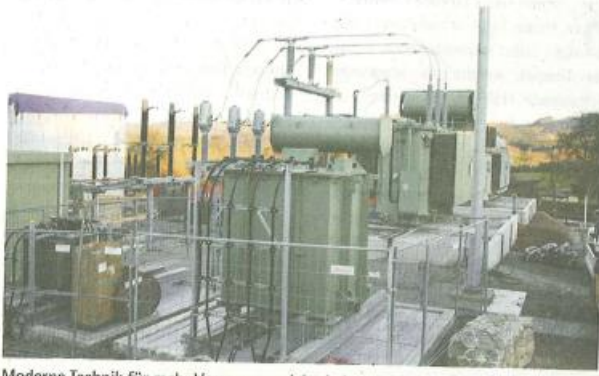
Moderne Technik für mehr Versorgungssicherheit.
