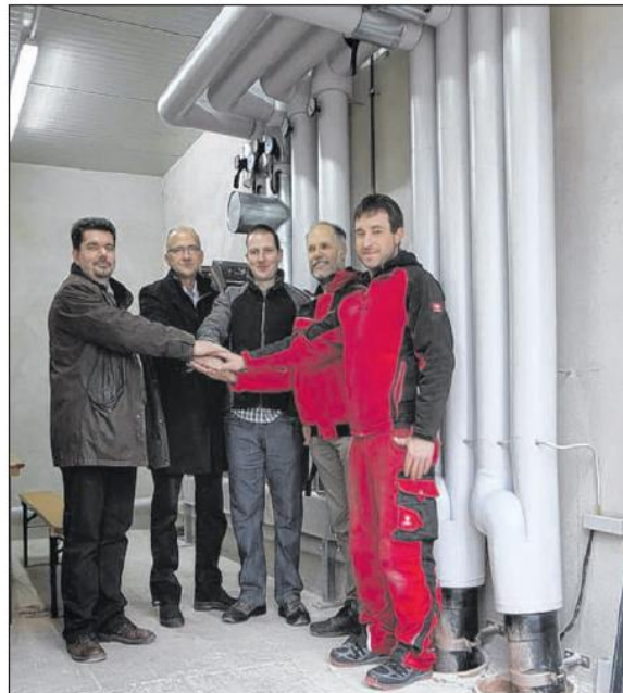
Freuen sich über das Nahwärmenetz in Rosengarten (von links): Thomas Hoppenz (Stadtwerke Schwäbisch Hall), Bürgermeister Jürgen König, Biogasanlagenbetreiber Gerhard Schreyer, Gottfried Gronbach und sein Mitarbeiter Thomas Hörterich.
