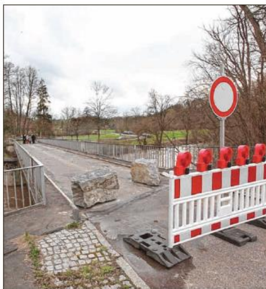
Seit Ende Januar fährt über die Kocherbrücke bei Wilhelmglück kein Auto und kein landwirtschaftliches Fahrzeug mehr. Ob und wie die Brücke saniert wird, ist weiterhin ungeklärt.
