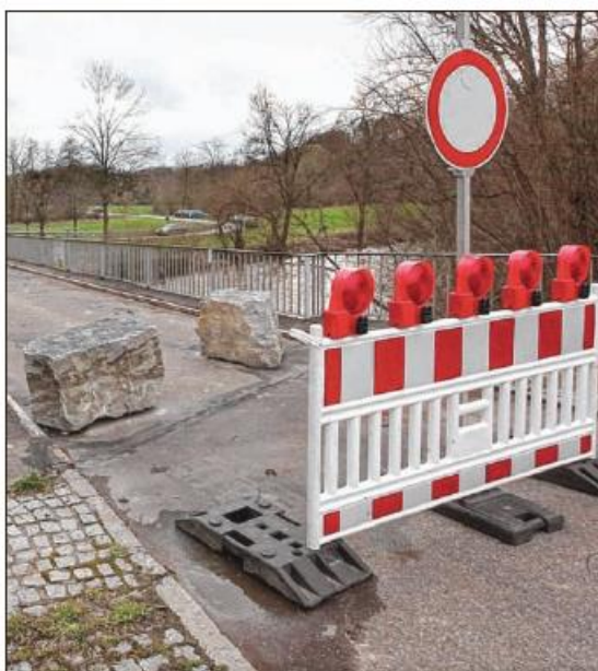
Seit Januar ist auf der Kocherbrücke im Verlauf der K2596 bei Wilhelmglück kein Durchkommen mehr. Jetzt saniert der Kreis eine Teilstrecke der Straße in Uttenhofen. Die Zukunft der Brücke bleibt ungewiss. Archivfoto: Ufuk Arslan
