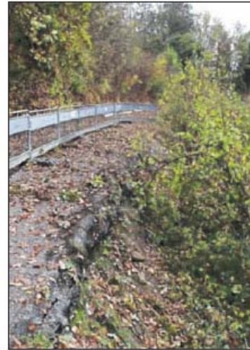
Der Hang zwischen Rieden und Kastenhof ist abgerutscht. Foto: Ufuk Arslan
