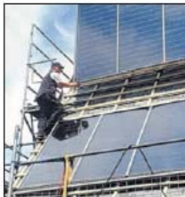
Nach wie vor werden im Kreis neue Photovoltaikanlagen gebaut. Archivfoto
