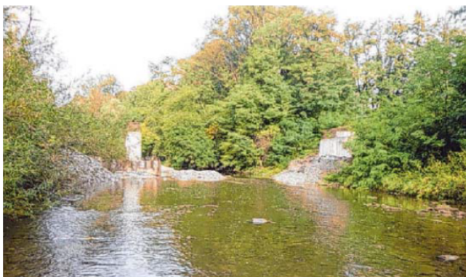
Die Kocherbrücke bei Wilhelmsglück war so marode, dass sie abgerissen werden musste. Derzeit wird sie neu gebaut. Foto: privat
