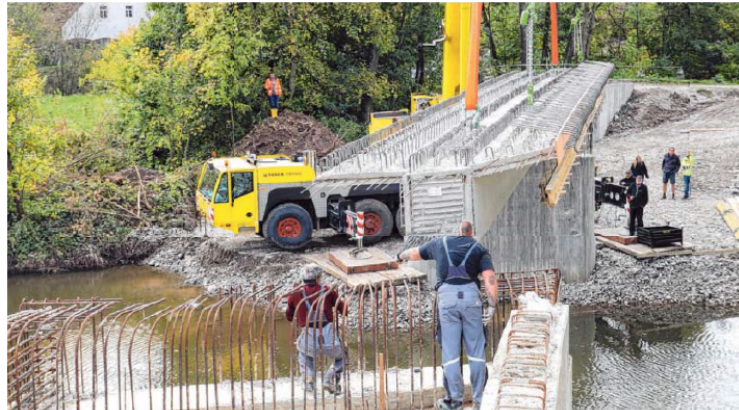
Per Kran wird der 40 Tonnen schwere Brückenträger auf Mittelpfeiler und Widerlager der Brücke aufgesetzt. Die Bauarbeiter leisten dabei Präzisionsarbeit. Foto: Gottfried Mahling
