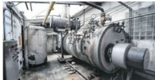
Dieser Dampfkessel erzeugte bis 160 Grad heißen Dampf für die Produktion.
