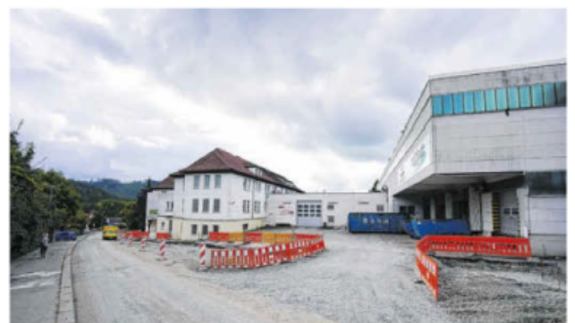
Auf dem Reutter-Areal soll ein Mischgebiet zum Wohnen, Arbeiten und Einkaufen entstehen. Foto: Archiv/Beatrice Schnelle
