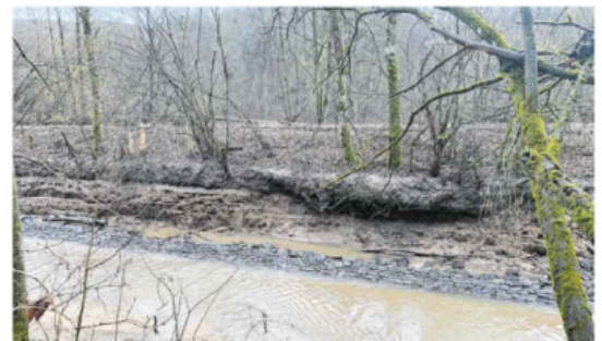
Vor der Abholaktion: Der Mühlkanal weist Schäden auf, die beseitigt werden müssen.
