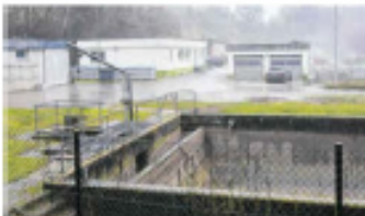
Im Klärwerk Rieden wird Abwasser behandelt. Foto: Archiv
