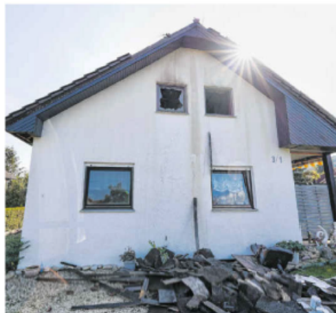
Das Brandhaus in Sanzenbach liegt in einer idyllischen Wohnstraße. Der Dachstuhl und das erste Obergeschoss wurden von den Flammen zerstört. Die Besitzer haben Zuflucht in der Ferienwohnung von Freunden gefunden. Foto: Beatrice Schnelle
