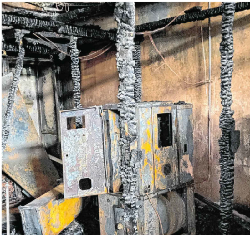
Der Brand bei der Firma HoRec Hohenloher Recycling GmbH in Uttenhofen zerstörte die Verkabelung der Spänebrikettieranlage. Foto: privat
