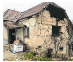
Tiefe Risse zeigen viele Häuser seit den Erdbeben. Foto: privat
